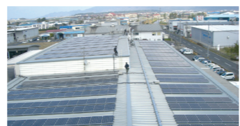
屋根の上と駐車場に設置された太陽光発電パネル
