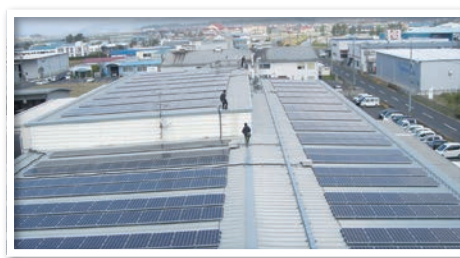
屋根の上と駐車場に設置された太陽光発電パネル
